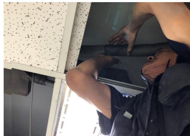
楠梓校區行政大樓冷風機排水管
