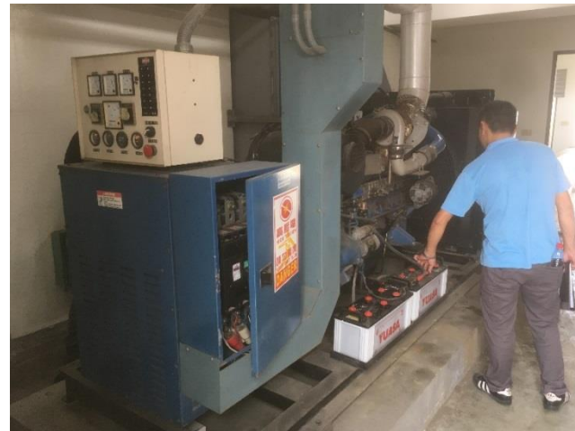
第一校區外語學院緊急發電機
