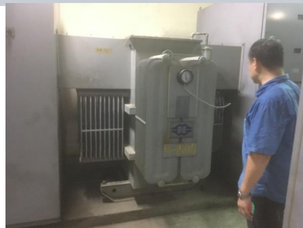
既設油浸式變壓器
