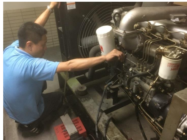
建工校區雙科館緊急發電機
