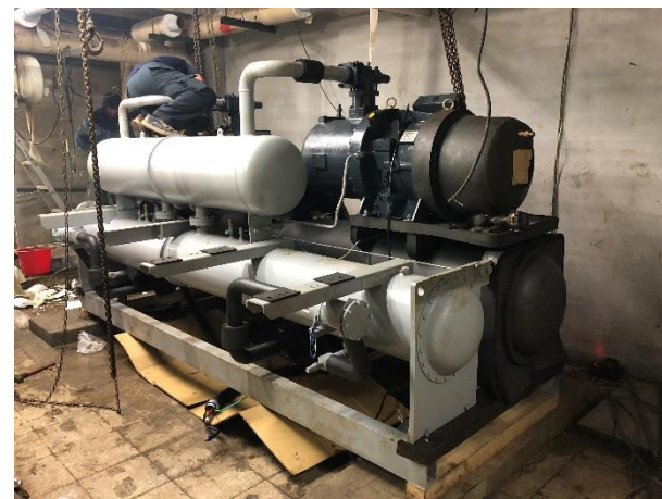
冰水主機定位
