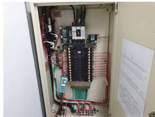
低壓電力盤負載量測
