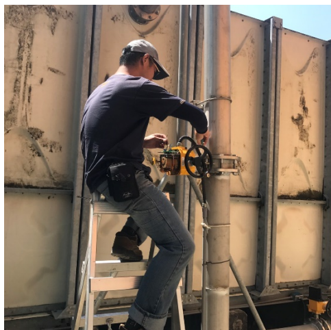
電動閥損壞修復
