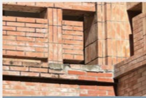
水泥砂漿底層龜裂
