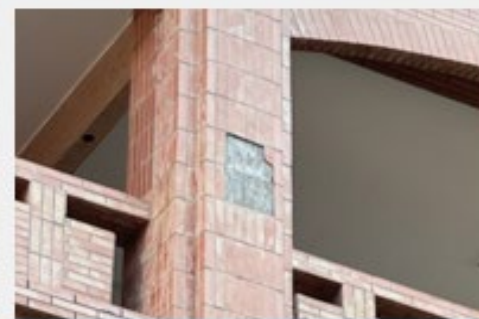
主柱牆磚脫落
