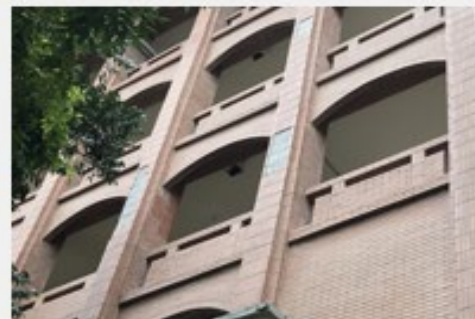
主柱牆磚脫落
