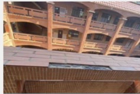
女兒牆磚脫落
