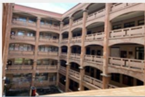
面磚多次修補，顏色不一
